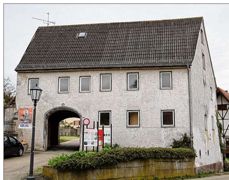
Die Schäden am Putz erkennt man deutlich: Für die Sanierung des Torhauses beim Schloss Brenz sind 20 000 Euro eingeplant.
